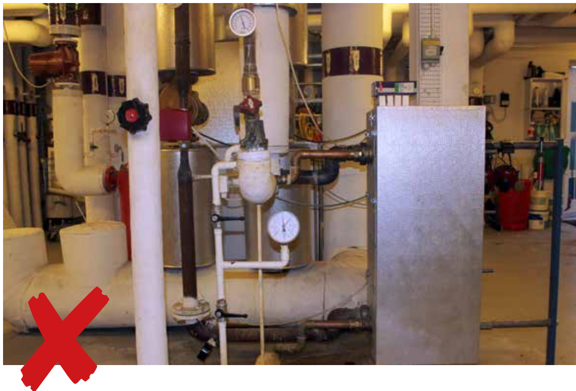
Figur 6.1 Brugsvandsveksler med manglende isolering på både primærsiden (sorte rør) og sekundærsi- den (kobberrør)
