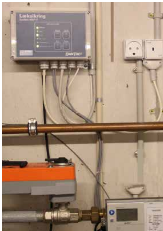
Figur 9.3 Billede af større lækagesikring
