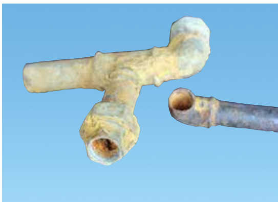
Figur 3.10 Varmforzinket stålør med tydelige korrosionsskader både indvendig og udvendig
