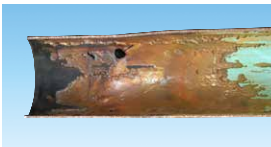
Figur 3.12 Eksempel på turbulentkorrosion i kobberrør
