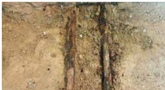
Figur 8.2 Eksempler på korroderede varmforzinkede stålør, der har været indstøbt
