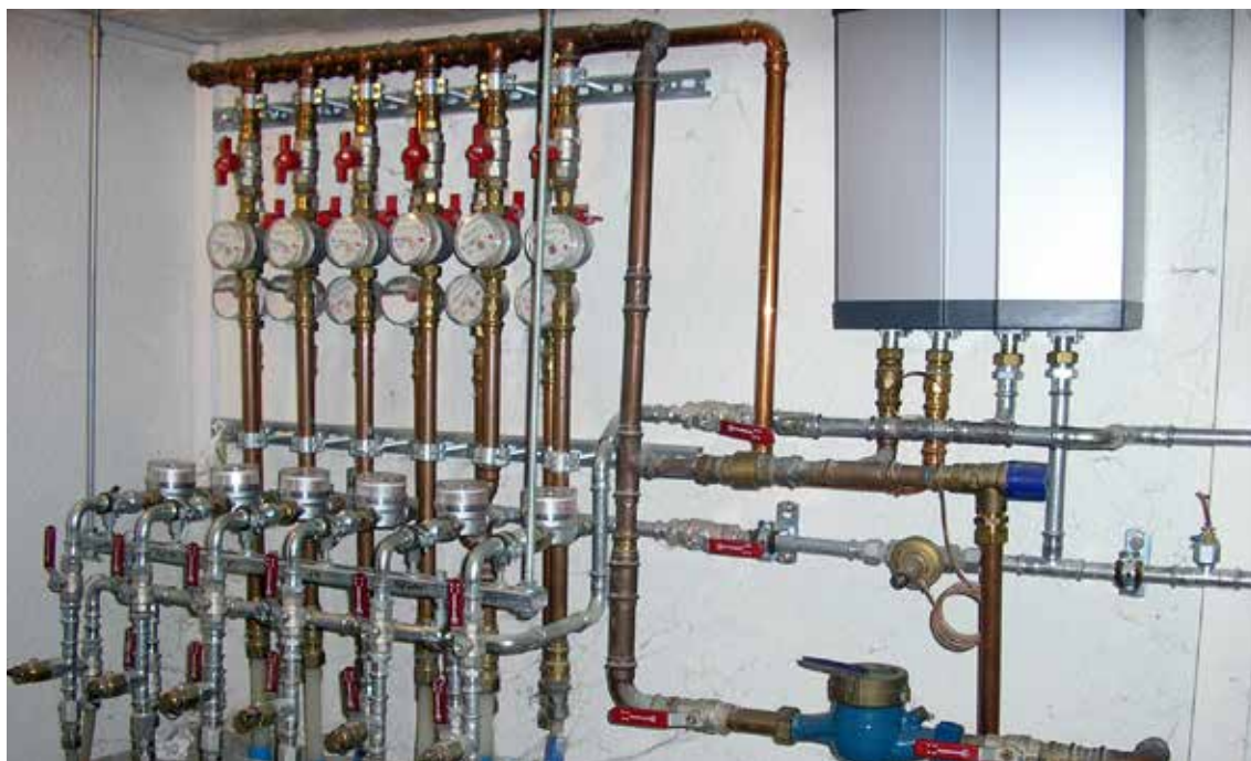
Figur 8.1 Eksempel på pæn og overskuelig installation med afspærringsventiler
